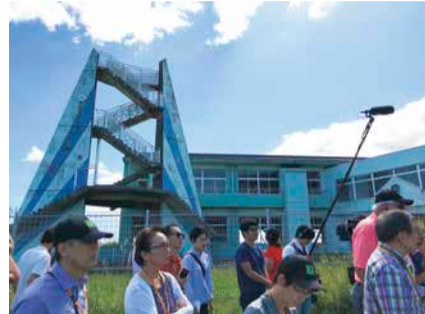
請戸小学校の1階は津波で窓ガラスがなくなった
